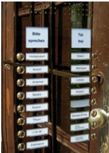
Bild 14: Lesbare Namen und visueller Kontakt ergänzen die Gegensprechanlage
