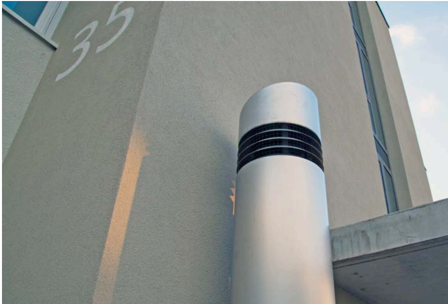
Detail: Zuluft der kontrollierten Wohnraumlüftung
