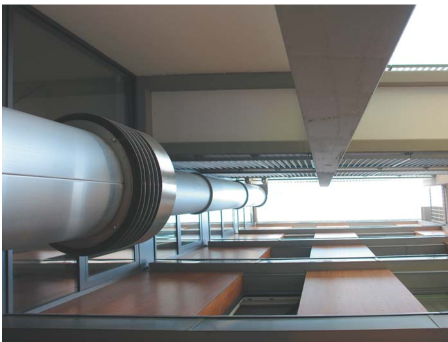
Frischluf- und Fortluftleitung der Lüftungsanlage
